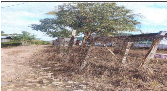
Foto 3: Se observa las mallas todo oxidado necesita reparacion
