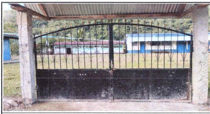
Foto 5: Se observa Porton en mal estado se necesita reparacion
