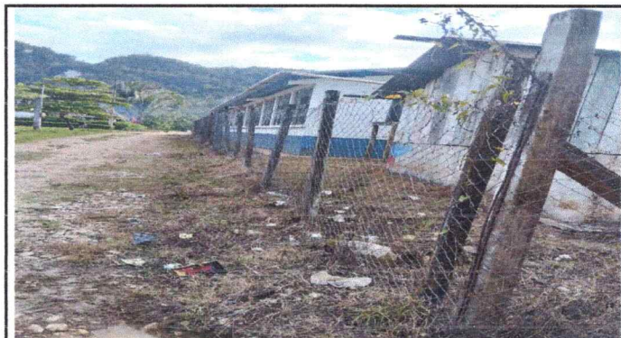
Foto 4: Se observa las mallas rotas necesita reparacion
